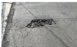
②道路損傷個所を撮影
