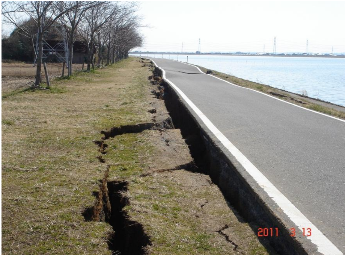
堤防道路の亀裂
