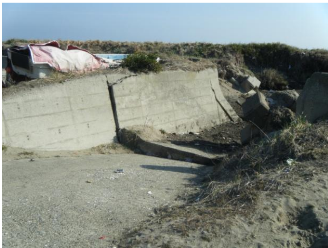
海岸進入路の損壊
