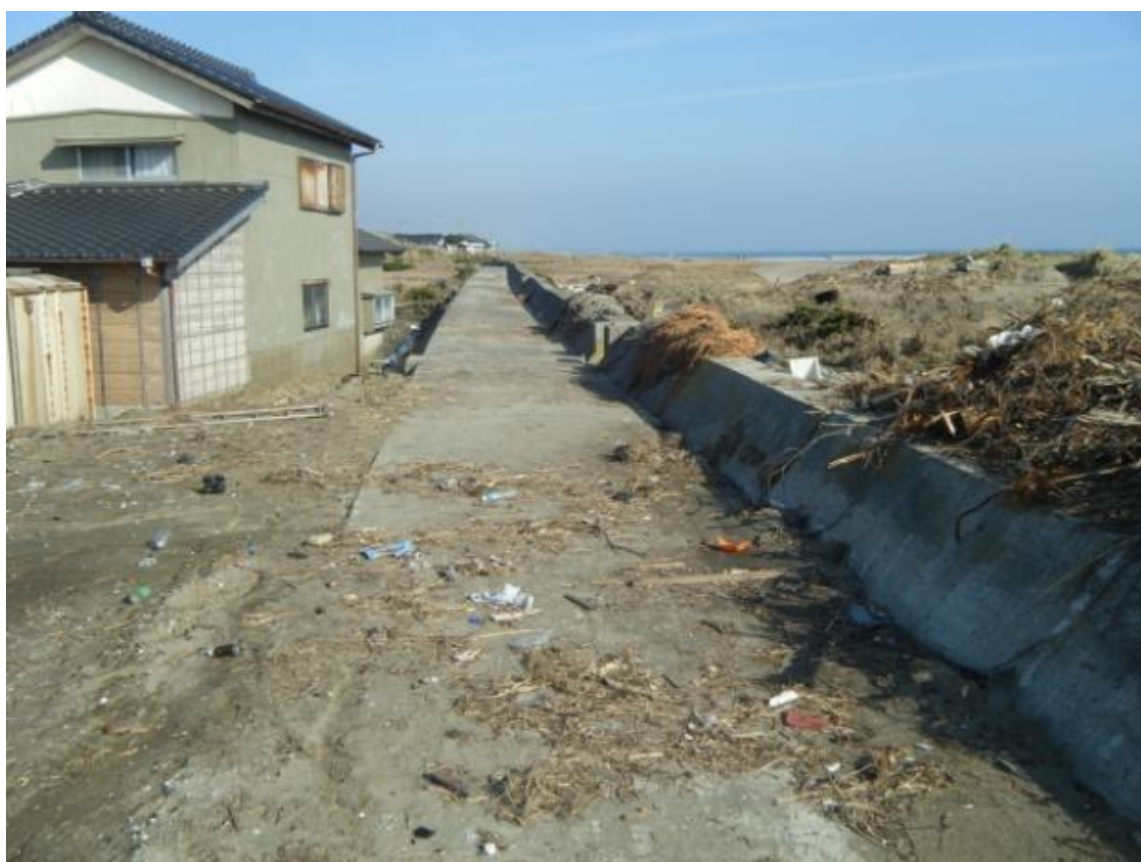
海岸施設の損壊
