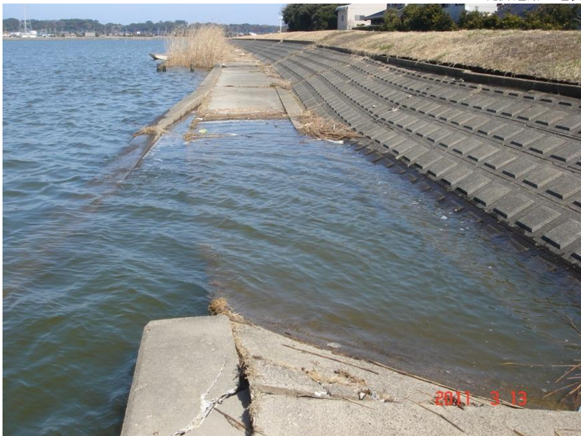
堤防施設の崩壊
