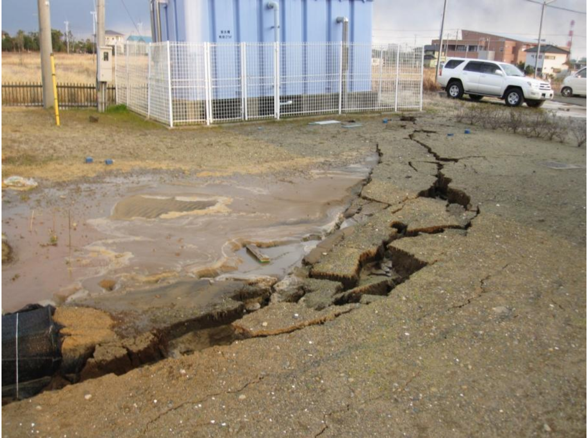
地盤沈下による路面の損壊
