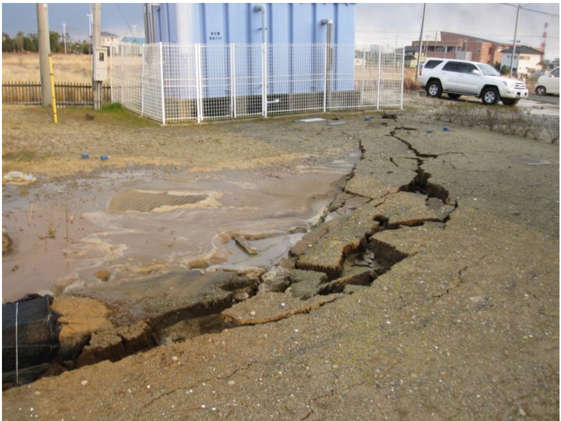
駐車場内の亀裂
