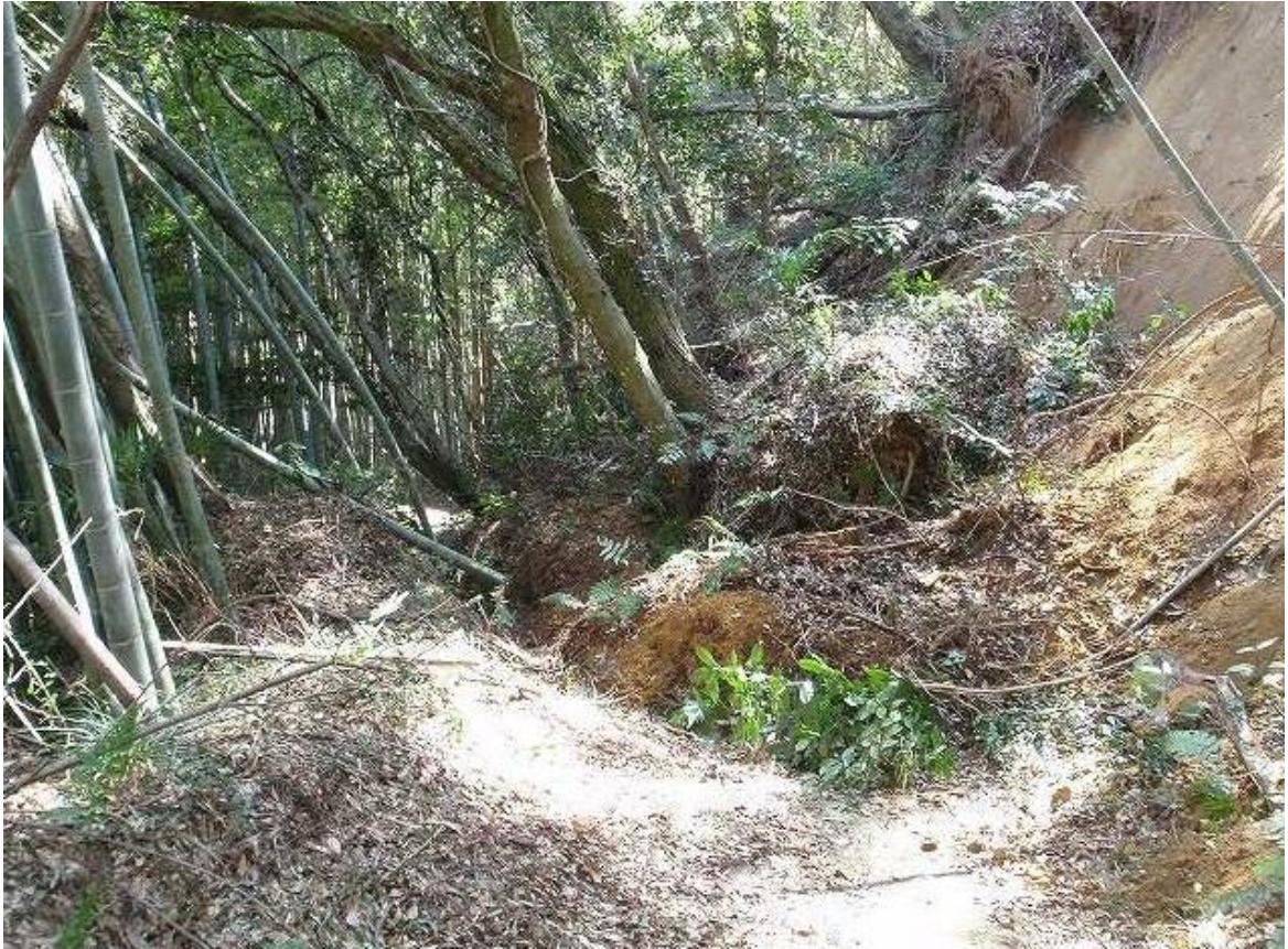
土砂崩れによる道路法面の崩壊
