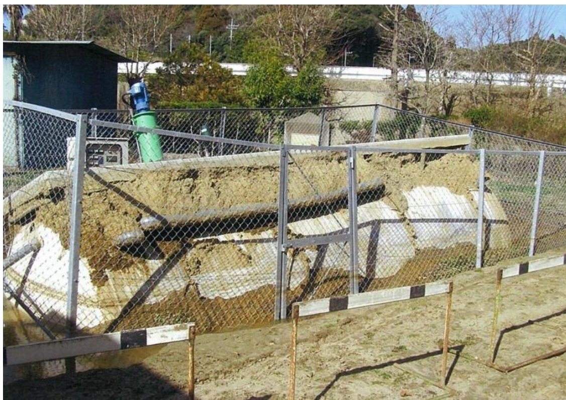
浄化槽の損壊（大同西小学校）
