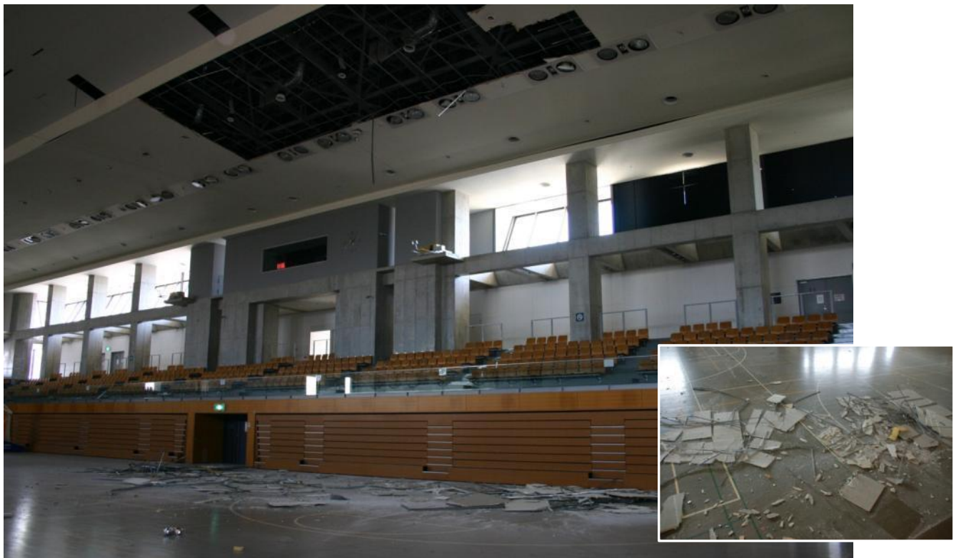
天井の落下（スポーツセンター）
